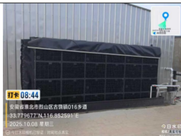
猪舍废气除臭墙
