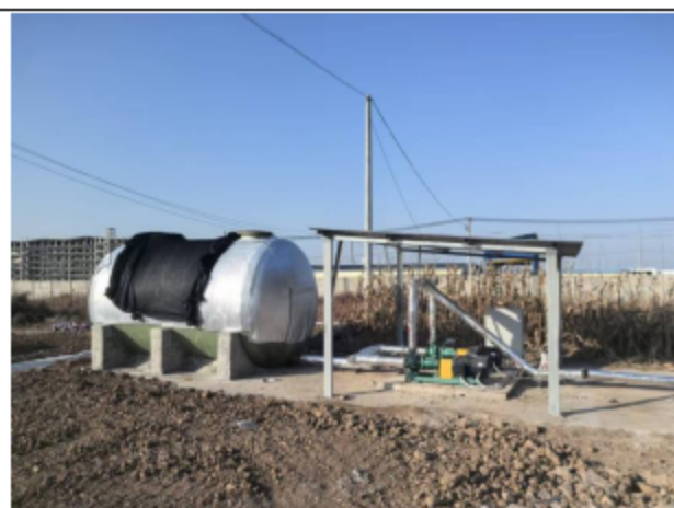
次氯酸钠（除臭剂）加药装置
