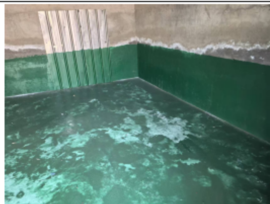
危废暂存间重点防渗
